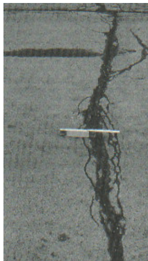
Figura A8-c. Grieta de reflexión de junta de alta severidad.
