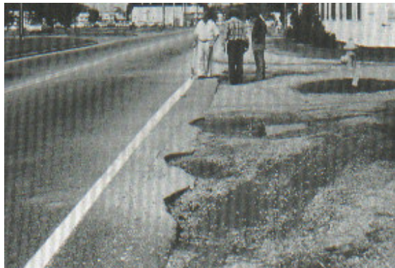
Figura A7-c. Grieta de borde de alta severidad.
