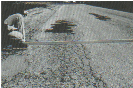
Figura A1-c. Piel de cocodrilo de alta severidad.
