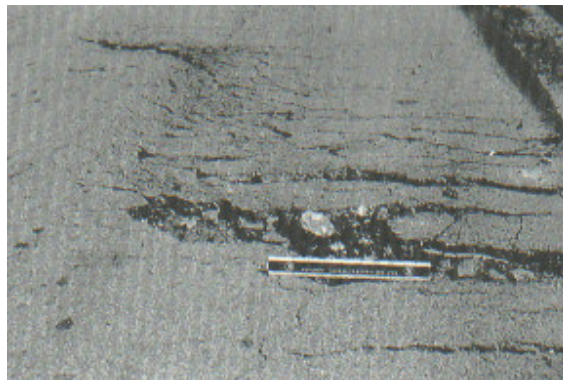
Figura A17-c. Grieta parabólica (slippage) de alta severidad.
