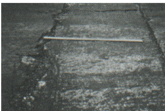
Figura C29-c. Parche grande y acometidas de servicios públicos de alta severidad.
