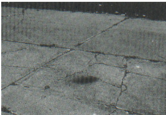
Figura C23-c. Losa dividida de alta severidad.
