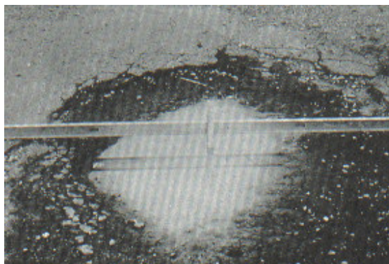
Figura A13-c. Hueco de severidad alta.
