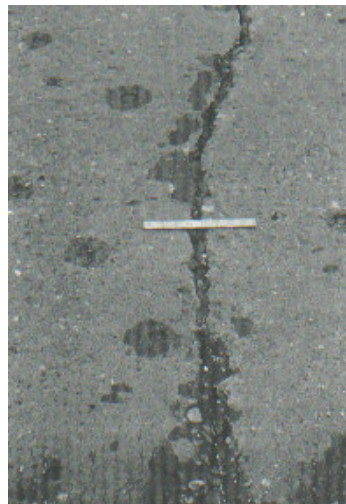
Figura C28-b. Grietas lineales de severidad media en losa de concreto reforzado.
