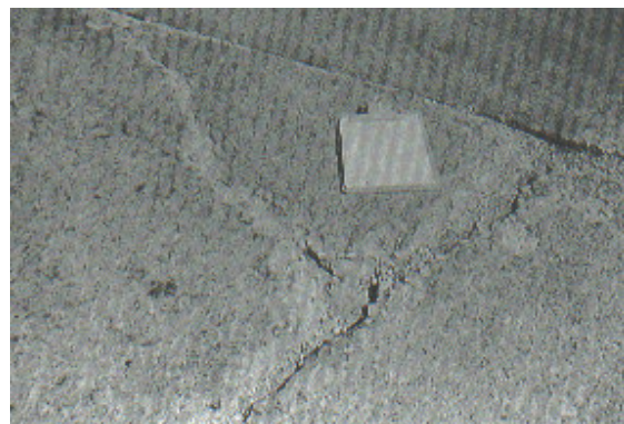
Figura C22-c. Grieta de esquina de alta severidad.
