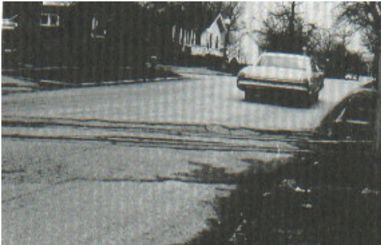
Figura A14-c. Cruce de vía férrea de severidad alta.
