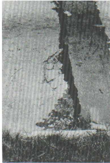
Figura C21-a. Blowup / Buckling de baja severidad.
