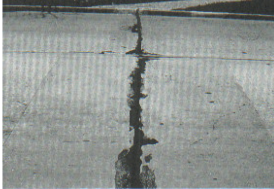
Figura C26-a. Daño del sello de junta de baja severidad.
