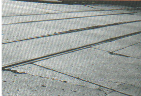
Figura C35-a. Cruce de vía férrea de baja severidad.
