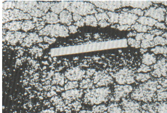
Figura A13-a. Hueco de baja severidad.
