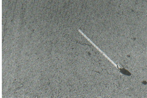
Figura A17-a. Grieta parabólica (slippage) de baja severidad.
