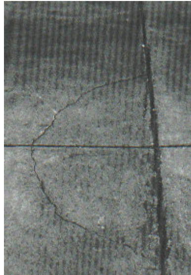
Figura C22-a. Grieta de esquina de baja severidad.
