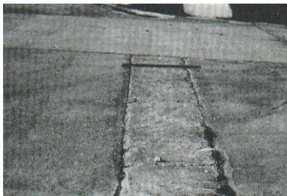
Figura C29-b. Parche grande y acometida de servicios públicos de severidad media.
