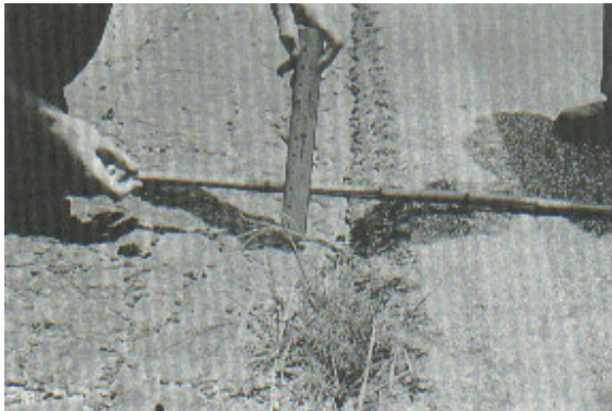
Figura A9-b. Desnivel carril / berma de severidad media.
