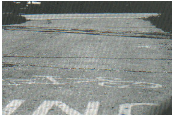
Figura C35-b. Cruce de vía férrea de severidad media.
