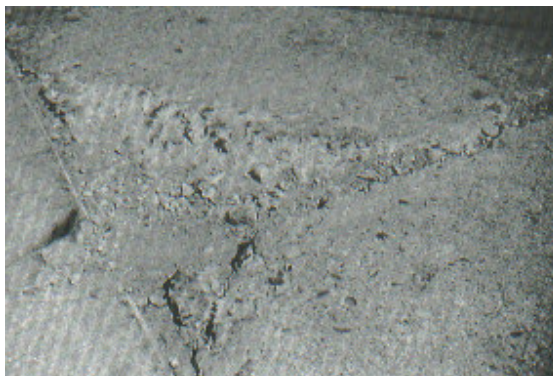
Figura C38-c. Descascaramiento de esquina de alta severidad.
