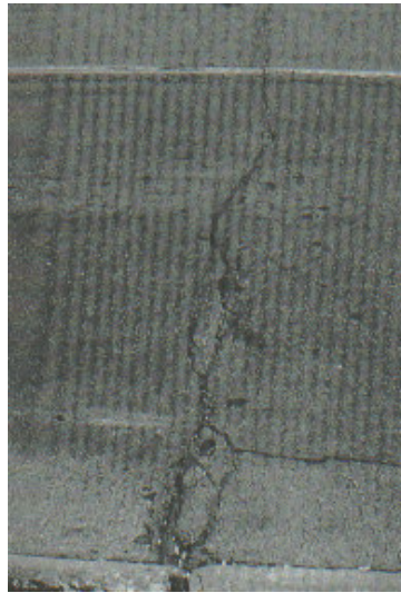
Figura A8-b. Grieta de reflexión de junta de severidad media.
