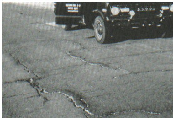
Figura A3-c. Grietas en bloque de alta severidad.
