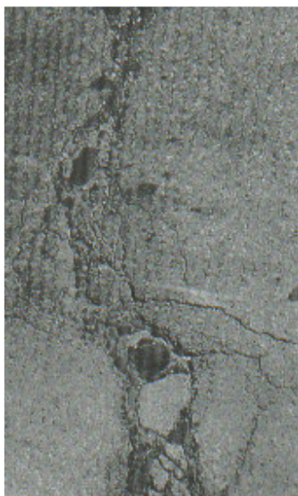
Figura A10-c. Grietas longitudinales y transversales (No PCC) de alta severidad.
