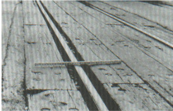
Figura A14-b. Cruce de vía férrea de severidad media.
