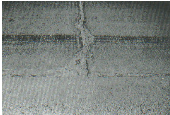
Figura C38-b. Descascaramiento de esquina de severidad media.
