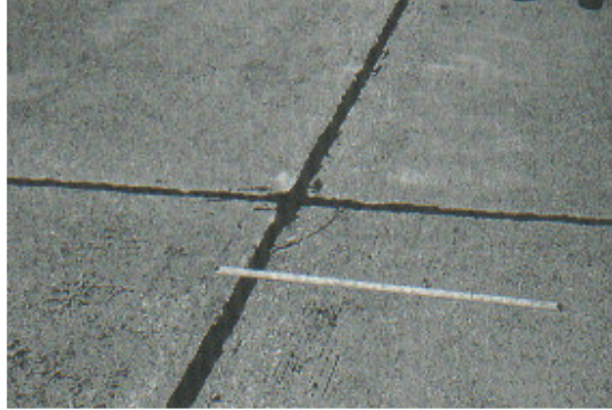
Figura C38-a. Descascaramiento de esquina de baja severidad.
