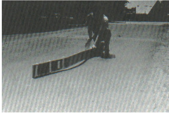
Figura A16-a. Desplazamiento de baja severidad.
