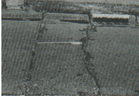
Figura C34-a. Punzonamiento de baja severidad.
