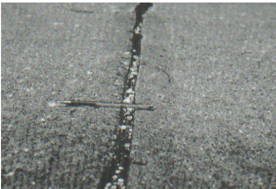
Figura C26-c. Daño del sello de junta de alta severidad.
