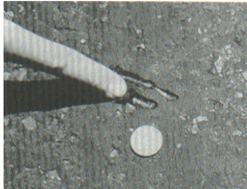
Figura A2-b. Exudación de severidad media.
