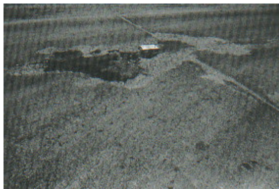
Figura C36-c. Desconchamiento / Mapa de grietas / Craquelado de alta severidad.
