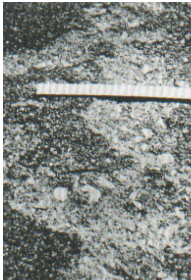
Figura C36-b. Desconchamiento / Mapa de grietas / Craquelado de severidad media.
