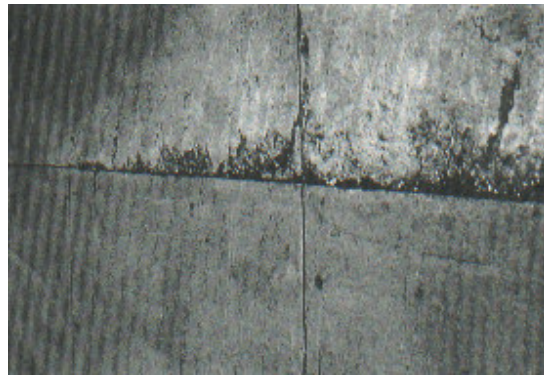
Figura C39-b. Descascaramiento de junta de severidad media.
