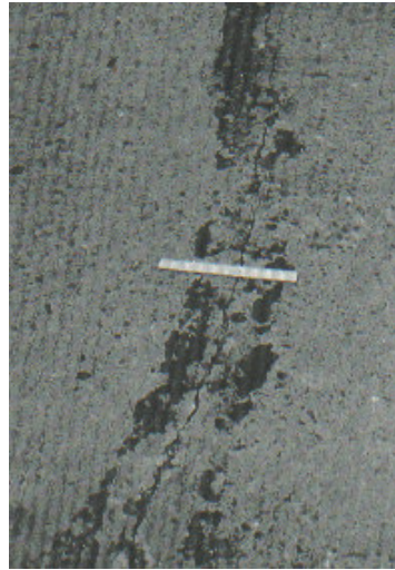
Figura C28-a. Grietas lineales de baja severidad en losa de concreto simple.
