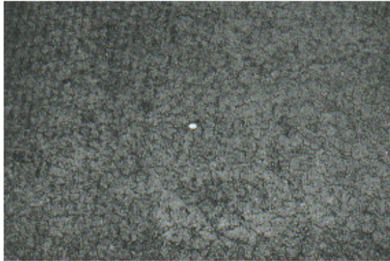
Figura C36-a. Desconchamiento / Mapa de grietas / Craquelado de baja severidad.
