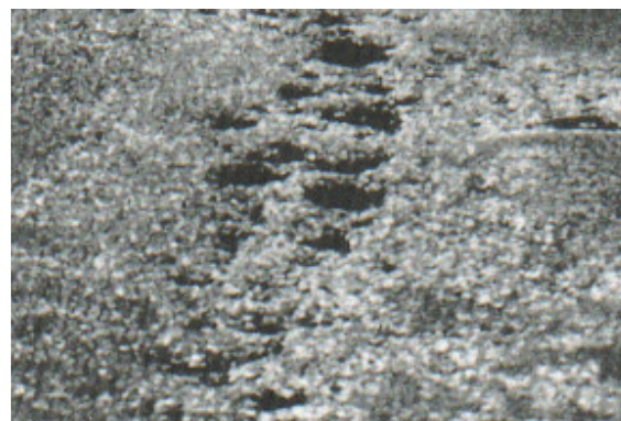
Figura A19-c. Meteorización / desprendimiento de agregados de alta severidad.
