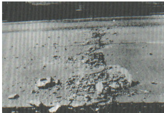
Figura C21-b. Blowup / Buckling de baja severidad.
