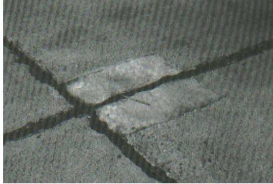
Figura C30-a. Parche pequeño de baja severidad.
