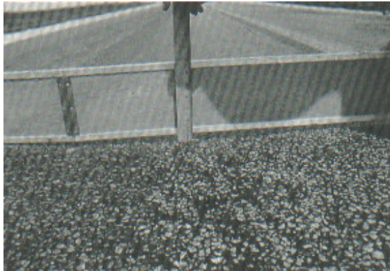
Figura A15-b. Ahuellamiento de severidad media.
