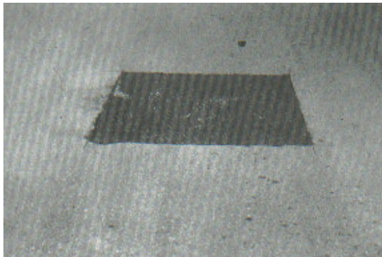
Figura A11-a. Parcheo y acometidas de servicios públicos de baja severidad.
