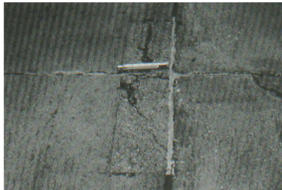
Figura C30-c. Parche pequeño de alta severidad.
