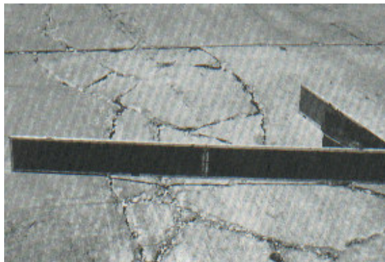
Figura C34-c. Punzonamiento de alta severidad.
