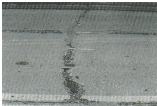
Figura C28-c. Grietas lineales de alta severidad en losa de concreto simple.
