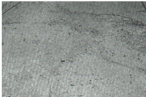
Figura C24-c. Grieta de durabilidad de alta severidad.
