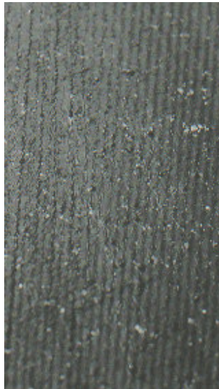
Figura A2-c. Exudación de alta severidad.
