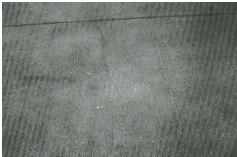
Figura C37. Grietas de contracción.
