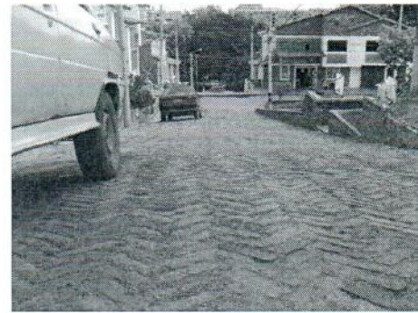
Figura 17. Desplazamiento de juntas
