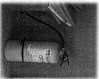
Imagen 107. Extintor multipropósito de la bodega
