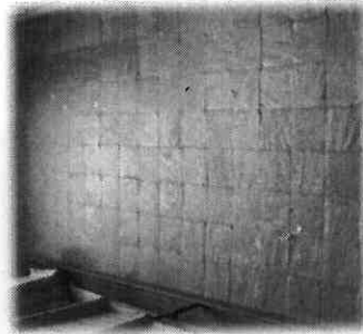
Imagen 67. Detalle de los pisos en las secciones 5 y 6 de la bodega SOP.
