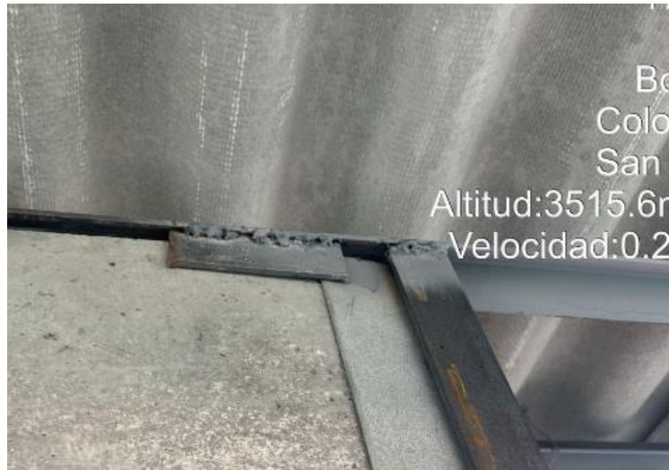
Ilustración 2. Soldadura de la estructura en malas condiciones. Foto 12-04-2024. Fuente OCI-UMV.
