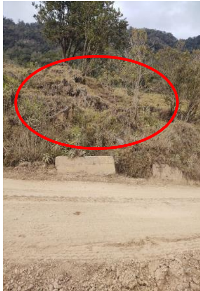
Ilustración 9. K0+850. Escarpe al lado de la vía. Foto 12-03-2024. OCI-UMV
