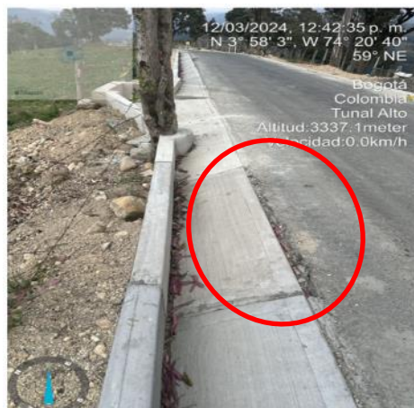
asfalto. Foto 12-03-24. Fuente OCI-UMV.
