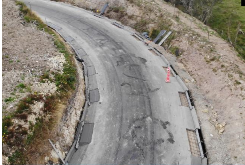
Ilustración 16. Avance de cunetas en el tramo Unión-Tunales. Se observan las fases constructivas de la cuneta. Foto 12-03-2024. Fuente OCI-UMV
