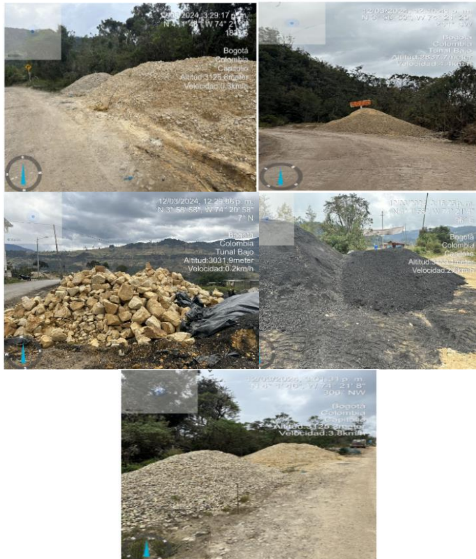
Ilustración 30. Materiales acopiados sin protección ni señalización. Foto 12-03-24. Fuente OCI-UMV.
