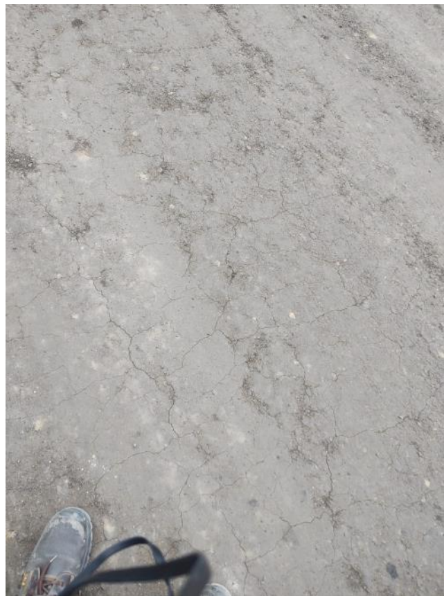
La impresión de este documento se con Ilustración 13. K2+900. Agrietamiento en fresado estabilizado. Localización 3.984,-74.354. Foto 12-03-2024. SISGESTION de la UAERMV
