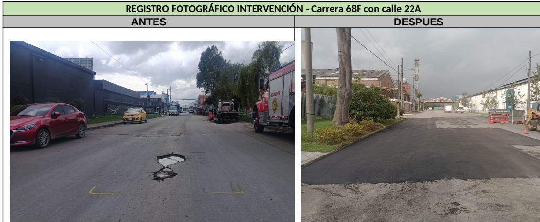
Ilustración .1. Intervenciones 9004001 PK 390301
