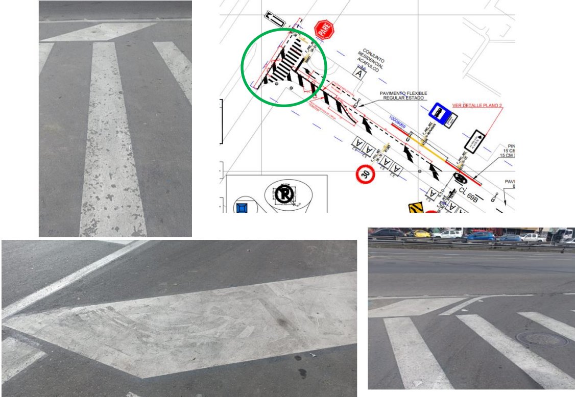
Ilustración 1 demarcación horizontal desgastado
