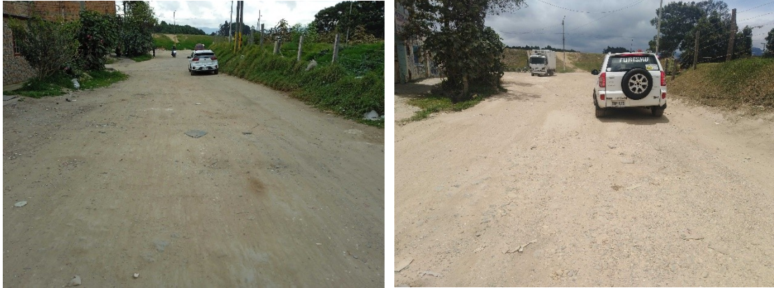
Figura 1 – Calle 49 Sur con Carrera 77H
