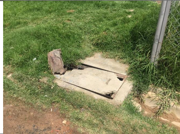
Tapa que actualmente se encuentra deteriorada y que en su momento fue entregada en óptimas condiciones de servicio.
